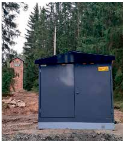
Vähä-Jaakkolan puistomuuntamo ja tiilikoppimuuntamo
