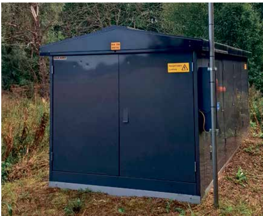
Prykin puistomuuntamo on lähellä kantatie 43:n ja Eurajoentien risteystä toisella puolella kantatietä. Melko lähellä muuntamon takana kiemurtelee uomassa Eurajoki.
